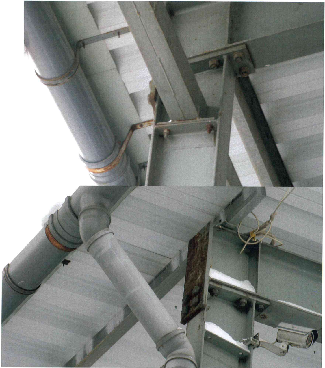
kolejne przykłady stanu węzłów konstrukcji hali-widoczna korozja powierzchniowa
