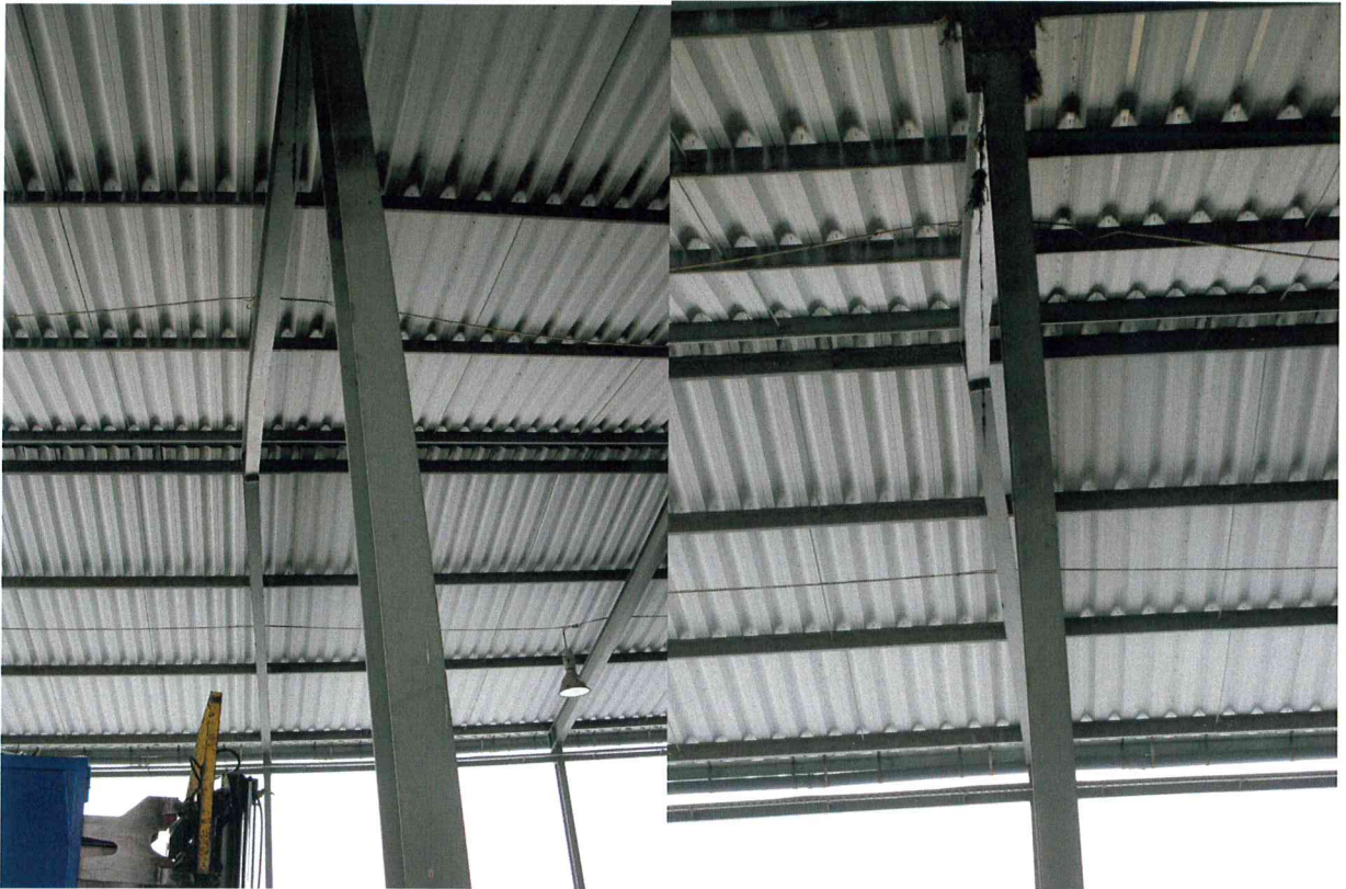
deformacja konstrukcji w trzeciej osi od strony wschodniej z powodu uderzenia w rygiel dachowy- przemieszczenia rygli oraz ugięcie słupa
