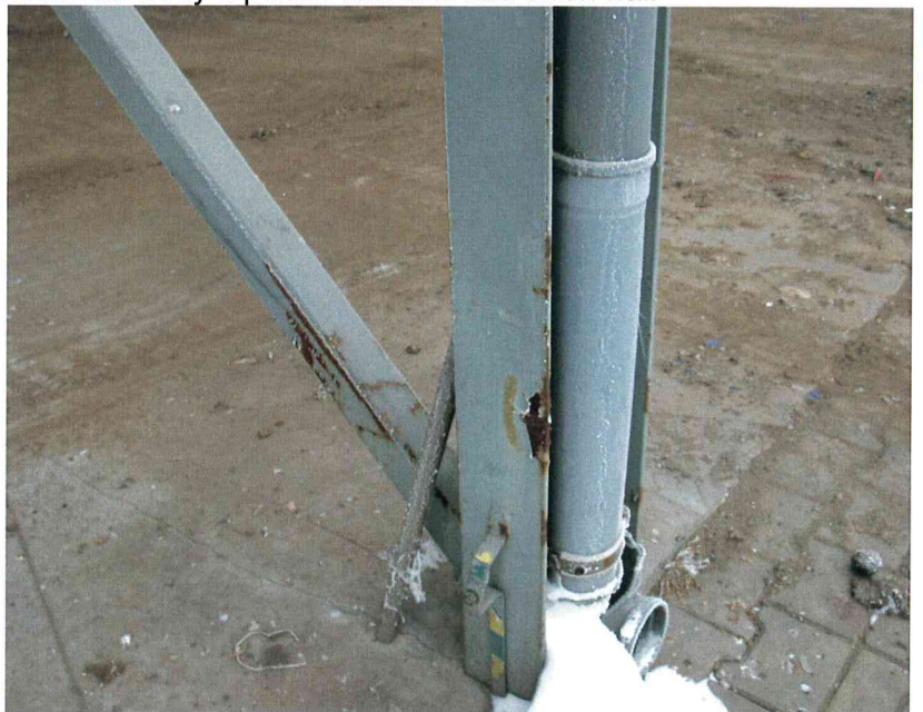
drobne uszkodzenia w nawierzchni konstrukcji, korozja powierzchniowa elementów stalowych
